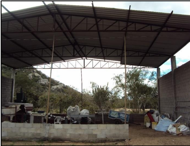
Figura 44 – Galpão preparado para a triagem de resíduos recicláveis.
