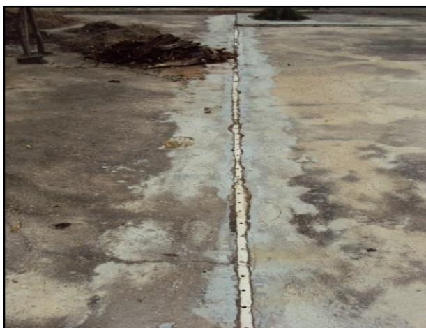
Figura 53 – Detalhe do sistema de coleta dos líquidos.
