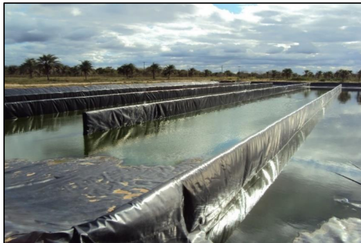
Figura 198 – ETE de Várzea da Roça
