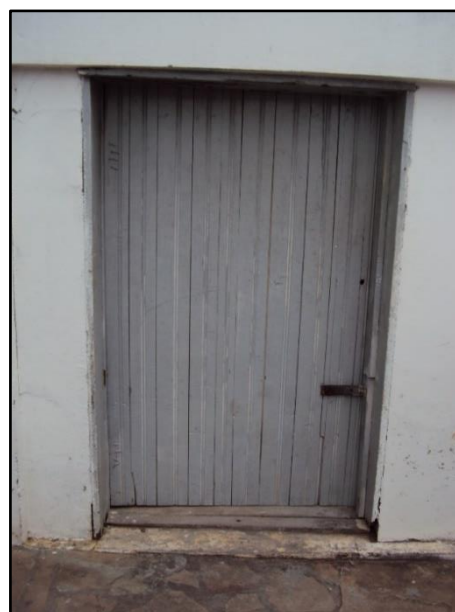
Figura 81 – Porta para o controle de acesso aos resíduos acondicionados.
