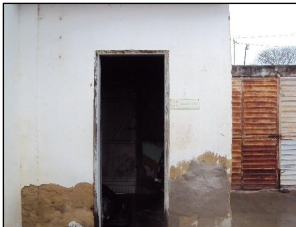
Figura 115 – Acesso ao local de armazenagem dos RSS.
